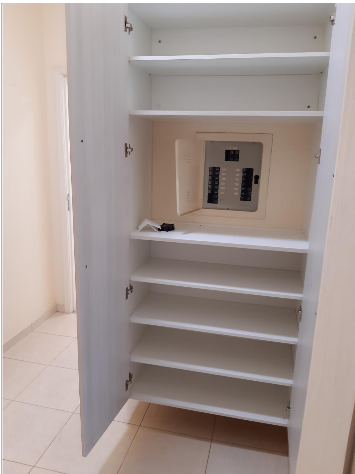
Quadro principal no hall em frente ao sanitário
