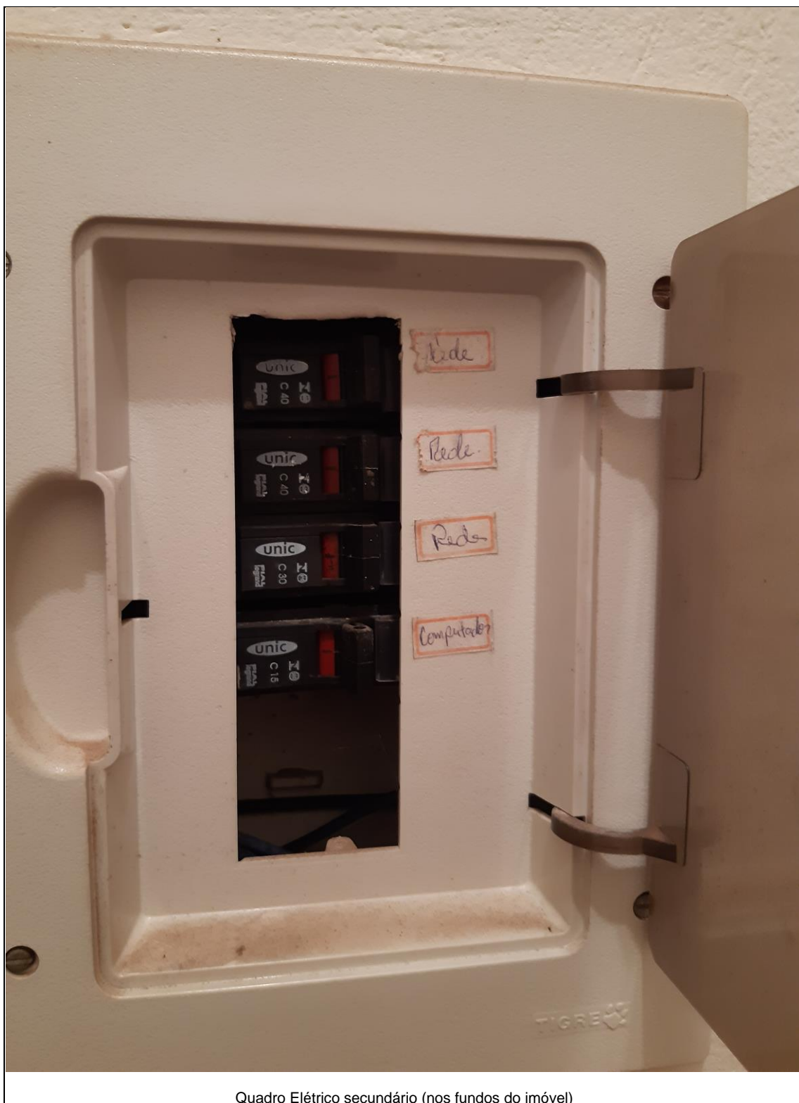
Quadro Elétrico secundário (nos fundos do imóvel)
